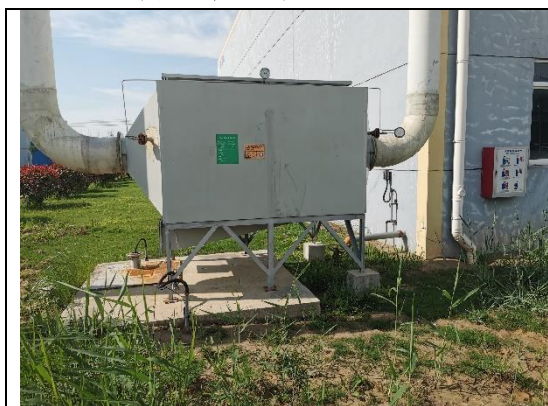
危废暂存库废气活性炭吸附装置
