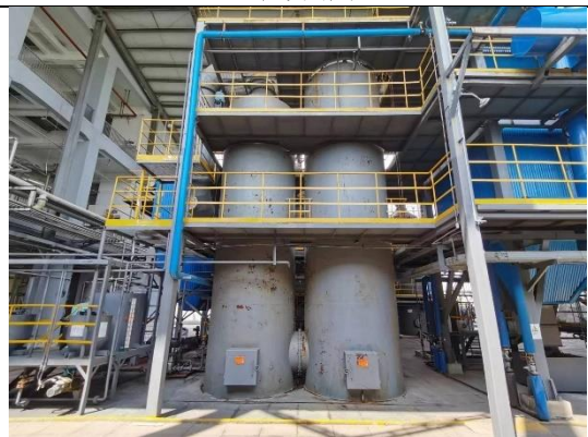
急冷塔+干喷塔
