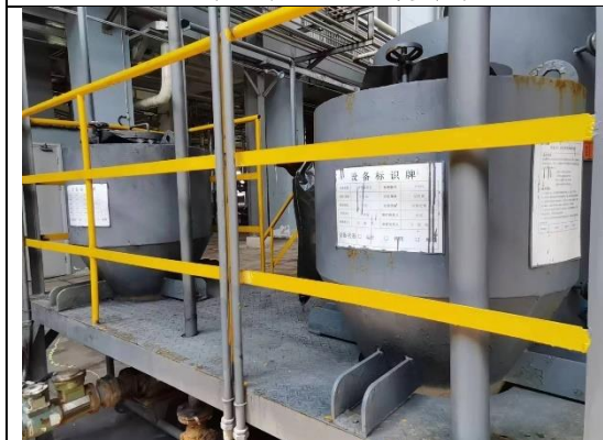
干喷塔活性炭、生石灰投料罐
