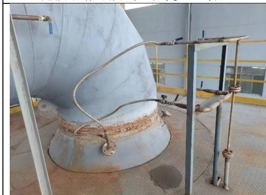
SNCR 脱硝喷淋装置
