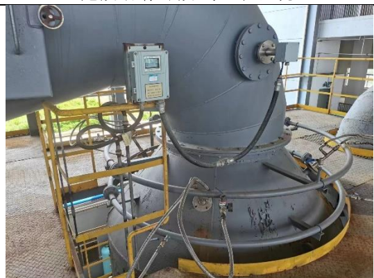
急冷塔喷淋装置
