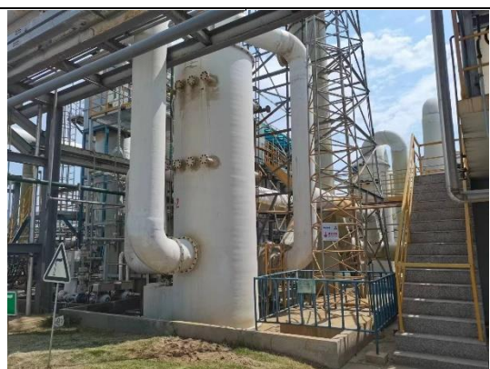
危废暂存库废气一级碱洗
