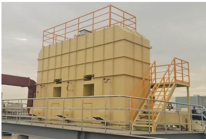
图 4.3-2 RCO 蓄热催化燃烧实物图
