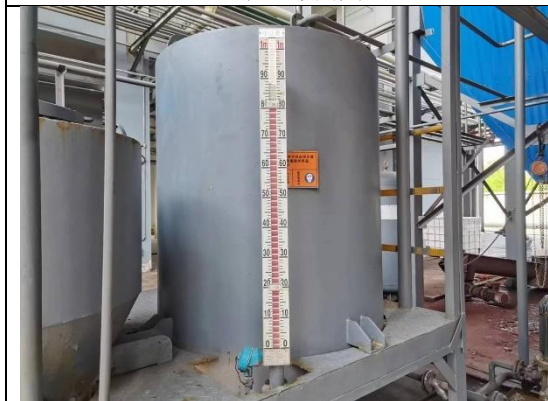
急冷塔碱性循环水缓冲罐
